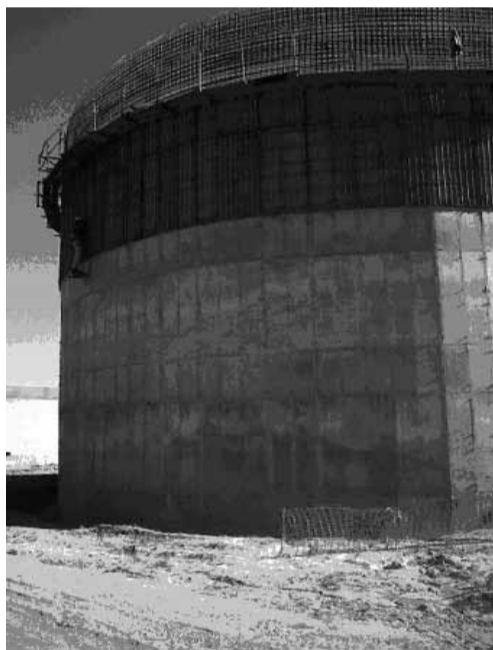
Digestor anaeróbico de lodos
